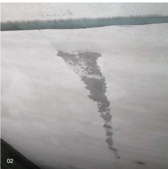
02 | Průsak po zkušební nalití vody na fólii
