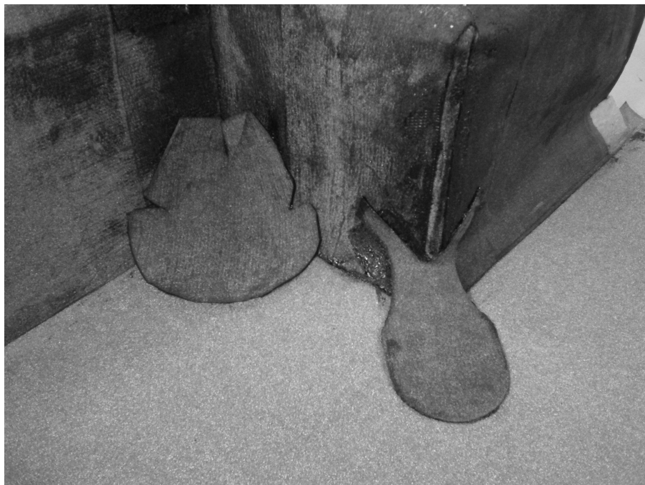
Obrázek /15/ Natavení univerzálních tvarovek 1 a 3 (bez posypu), asfaltový pás z plochy je přiveden k detailu
