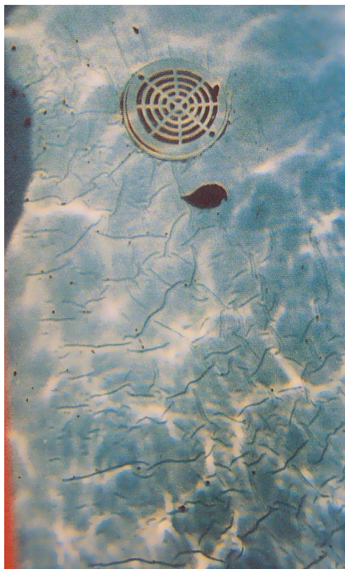
Foto 18. Zvrásnění fólie v důsledku nesprávného použití bazénové chemie.
