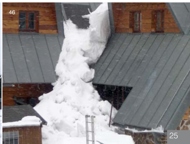
46| Detail úžlabí z /obr. 45/. Provozní vstup je zasypán sněhem
